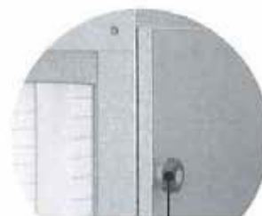
フィルター点検 点検扉の開閉はノブボルトタイプを使用。
